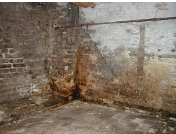
Murværk i kælder: Beskadiget murværk i kælder som følge af saltsprængninger
