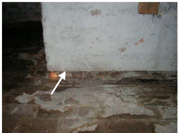
Murværk i kælder: Horizontalspærre er intakt her og skader er begrænset til under denne.
